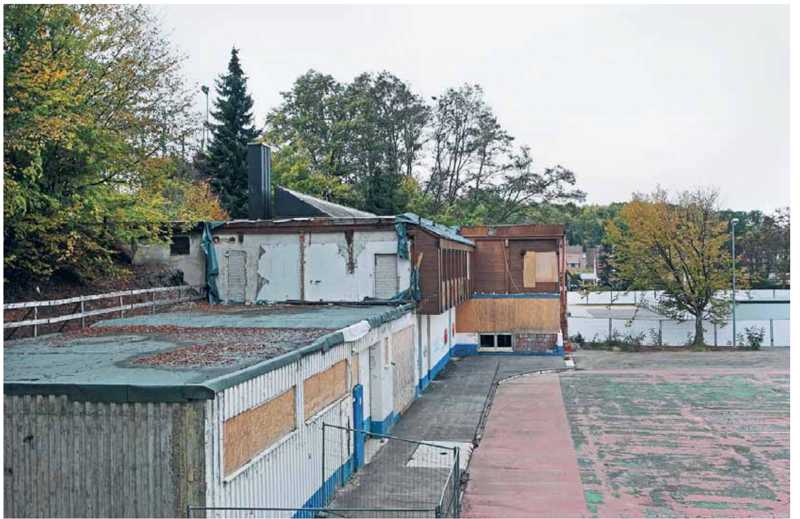
Schön sind sie nicht, aber nützlich: Ohne die Reste der alten Aalener Eishalle würde der dahinter befindliche Hang ins Rutschen kommen. Deshalb bleiben sie vorerst einfach stehen.
